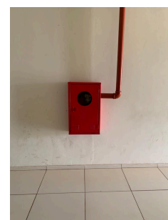
Figura 5 - Falta de sinalização
